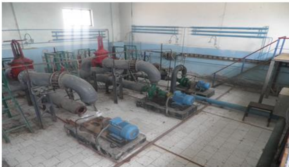
Рисунок 3 - Иловая насосная станция
